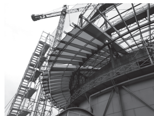
Blick von unten auf die Kragträger. Die Montage der Membran ist im Gang
