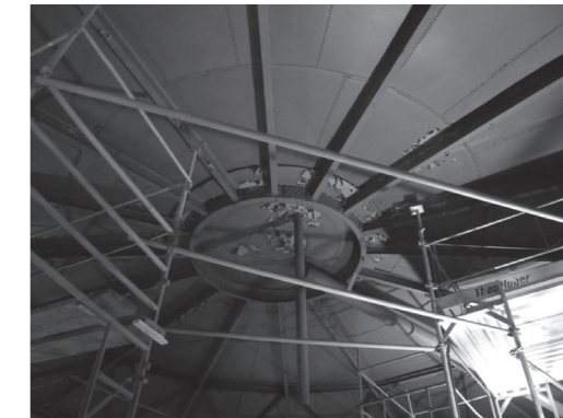
Dachunterseite des Gasometers mit abblätterndem Korrosionsschutz, aufgenommen bei einem Augenschein 2013
