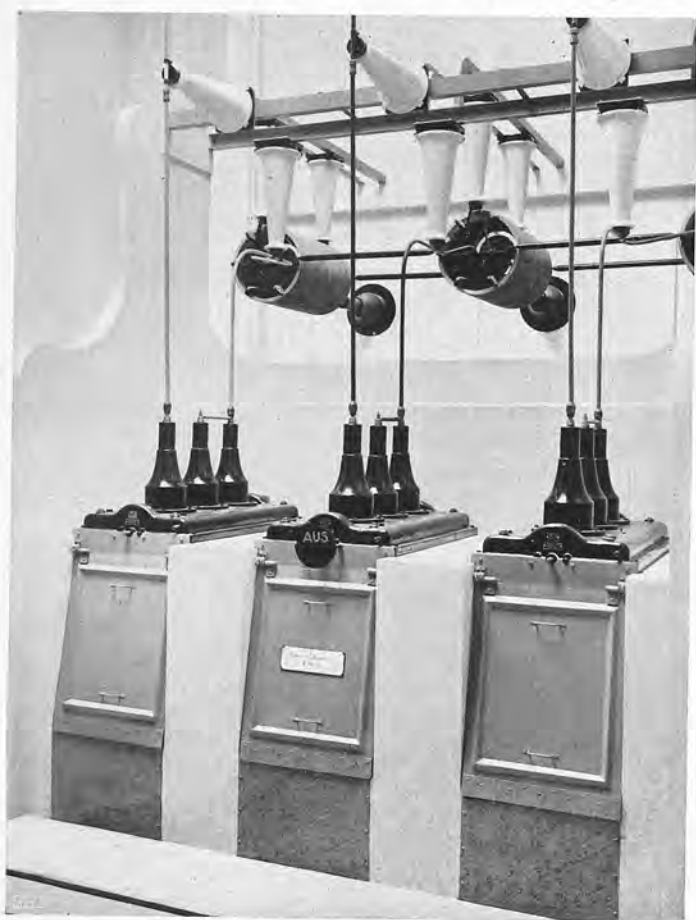
Abb. 134. Transformatoren-Schalter für 70 000 V mit Drosselspulen.
