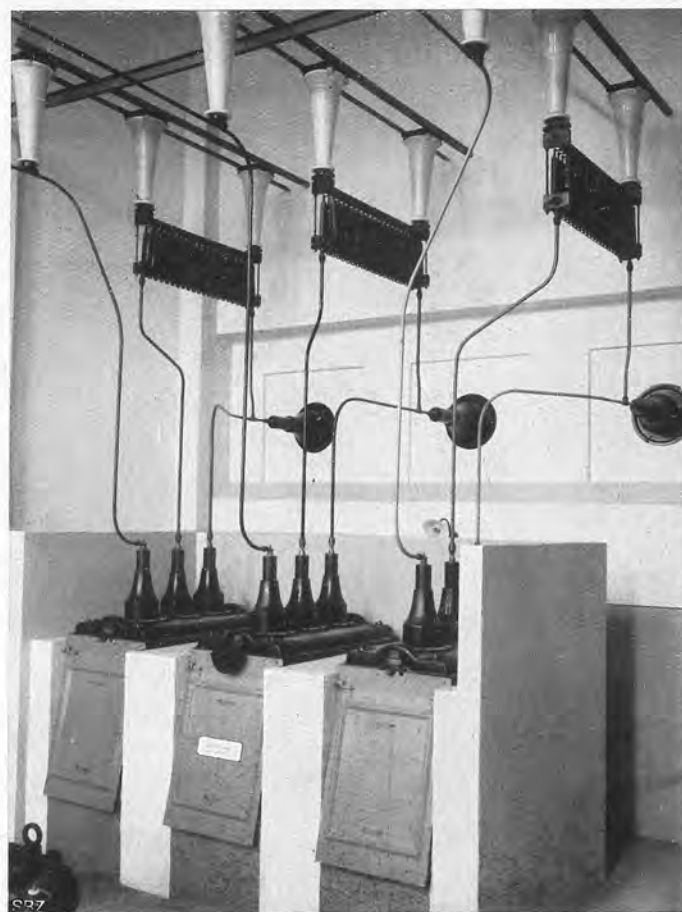
Abb. 136. Feeder-Schalter für 70 000 V mit Schutzwiderständen.
