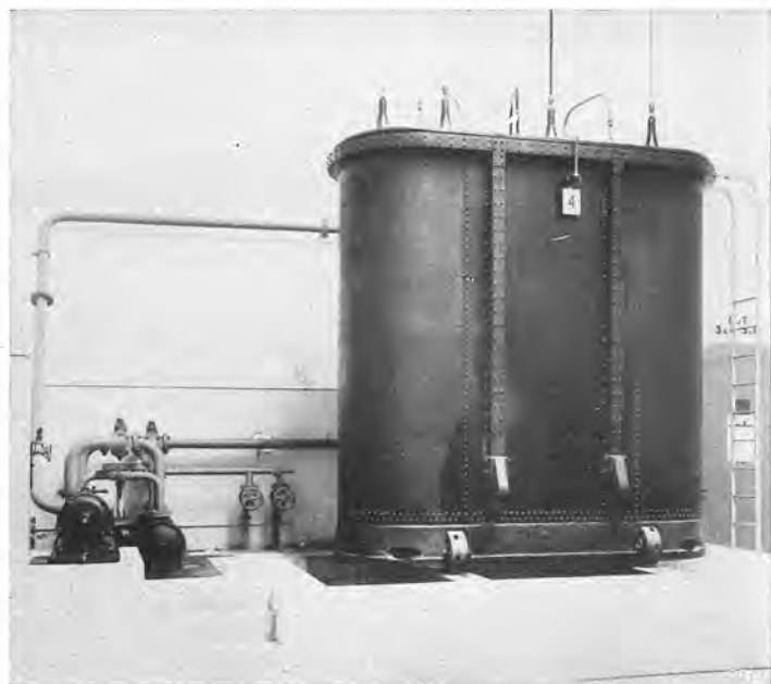
Abb. 124. Drehstrom-Transformator mit seinen Kühleinrichtungen.
