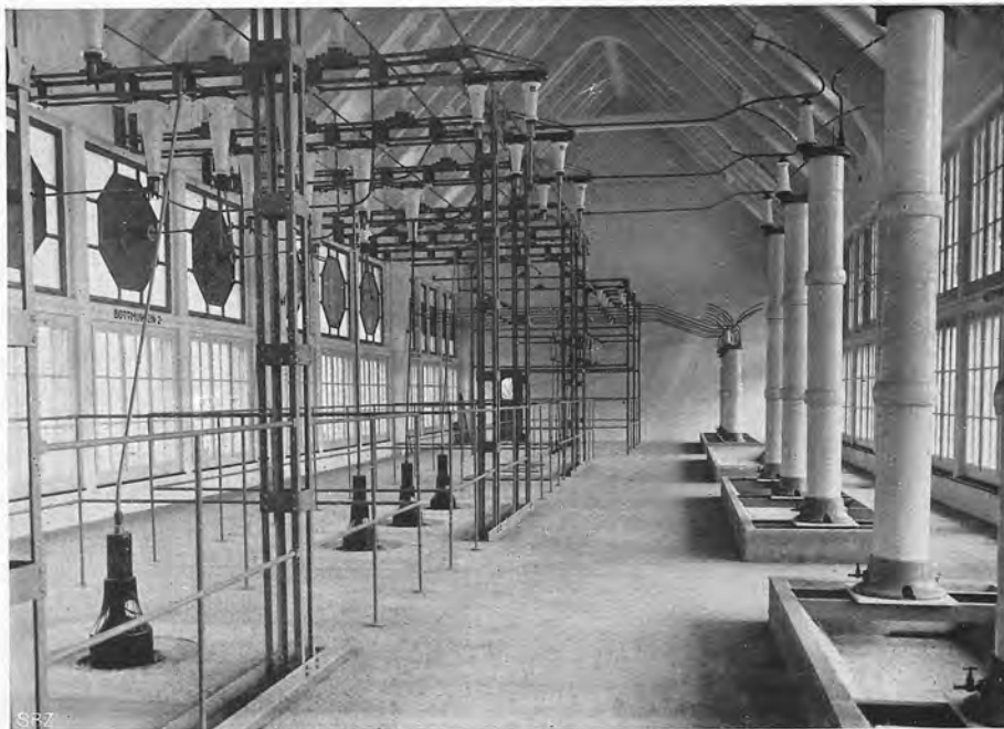
Abb. 137. Blitzschutz- und Ausführungsraum für 50 000/70 000 V.
