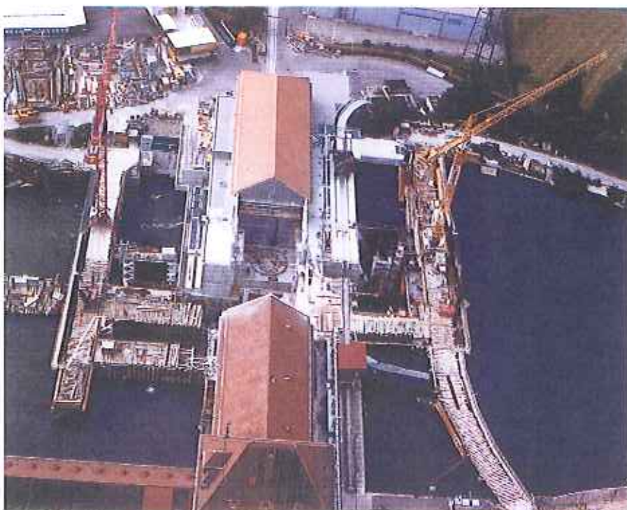
Bild B6-6. Luftaufnahme Ende 2. Bauetappe/Beginn 3. Bauetappe mit den Uminstallationsarbeiten der Baugruben im OW und UW.
