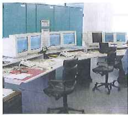
Bild B8-3. Kraftwerksleitstand Gösgen.
