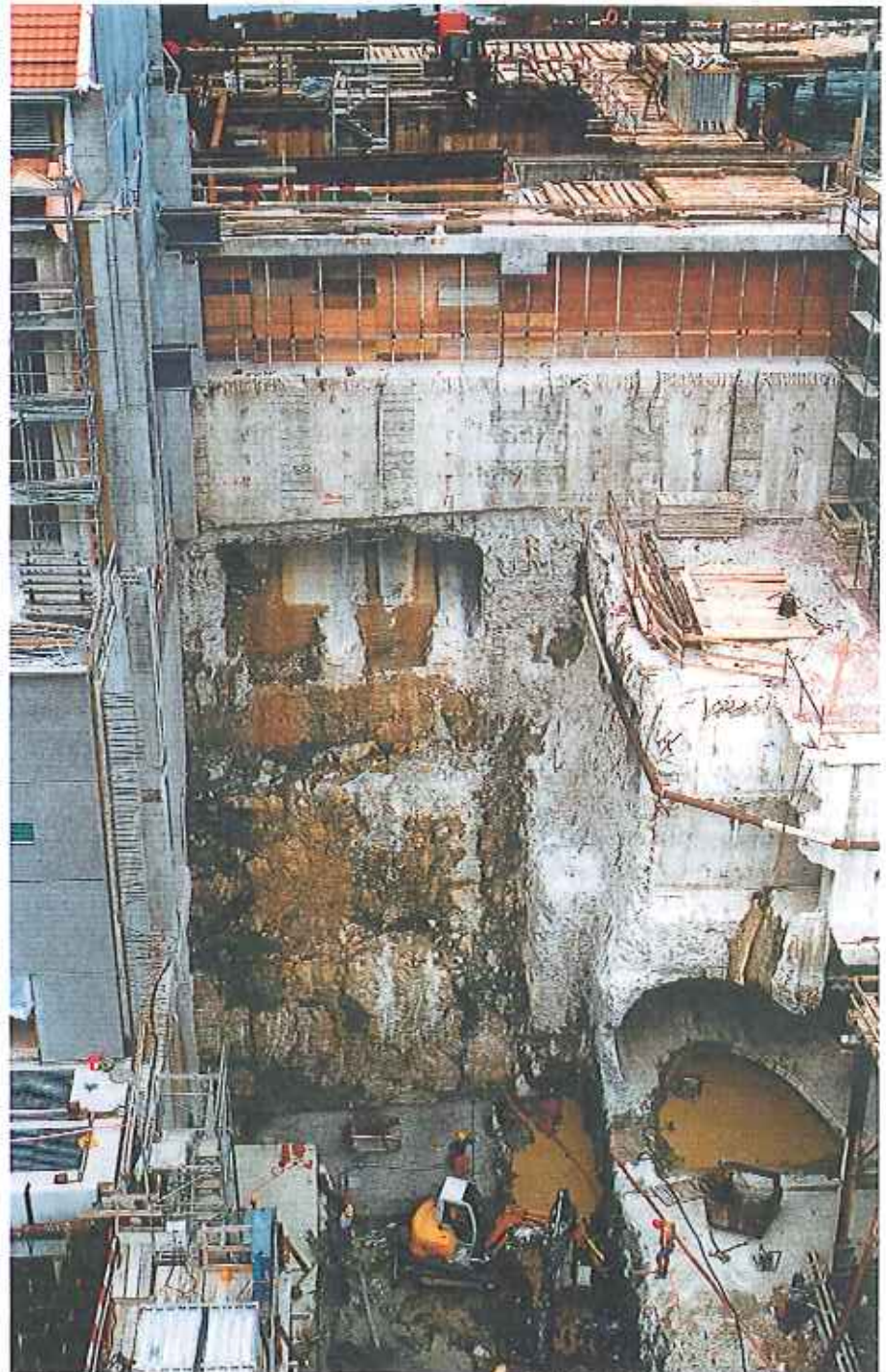
Bild B6-8. Fertig gestellte Abbrucharbeiten während der 4. Bauetappe. Die Fundation des neuen Saugrohres liegt tiefer als die alte Konstruktion (rechts im Bild).
