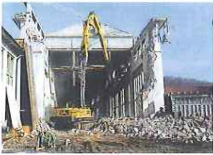
Bild B6-9. Betonabbruch während der 1. Bauetappe.
