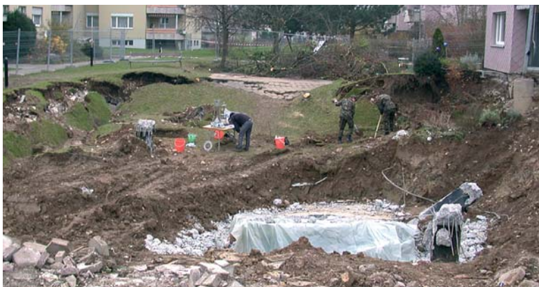
Fig. 1 Défaillance d'un plafond de parking souterrain à Gretzenbach (CH), 2004. Collapse of the roof of an underground car park in Gretzenbach (CH), 2004.
