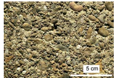
Fig. 1 Erodierte Betonoberfläche in einer ARA.
