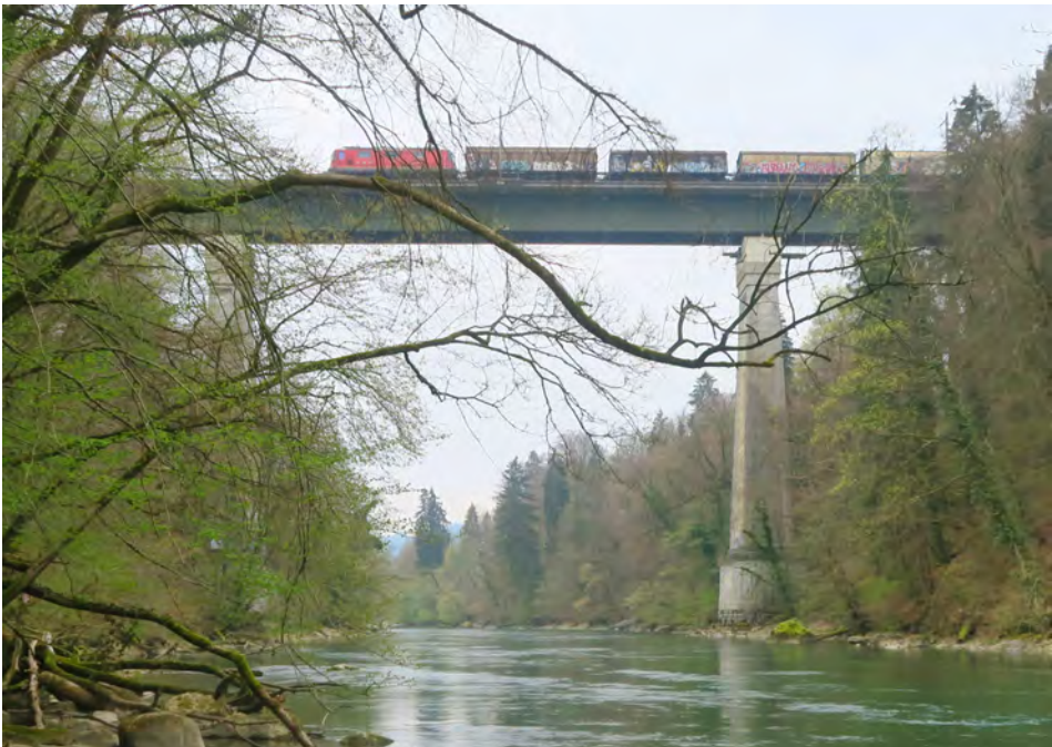
Figure 3.15 : Le pont sur la Reuss de Melligen en 2019, vue vers l'amont en direction du sud. La colline de Gruemet est située sur le côté gauche de l'image, avant la gare de Melligen-Heitersberg et le portail du tunnel du Heitersberg, en direction de Zurich.
