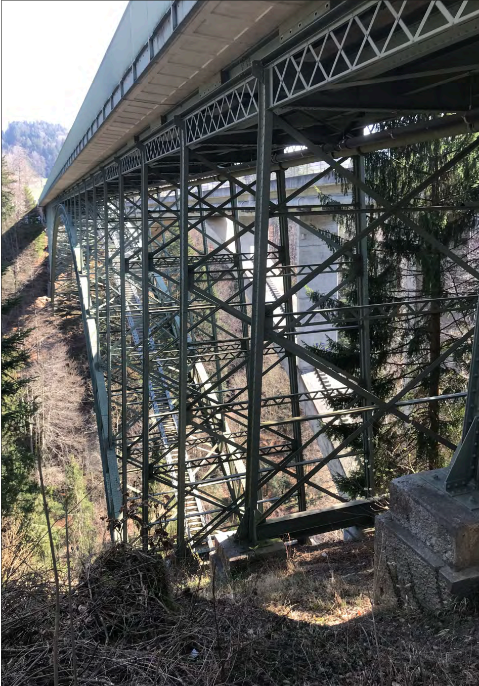
Figure 3.29 : Le pont routier métallique sur la Schwarzwasser en 2019. A droite, le pont ferroviaire en béton.
