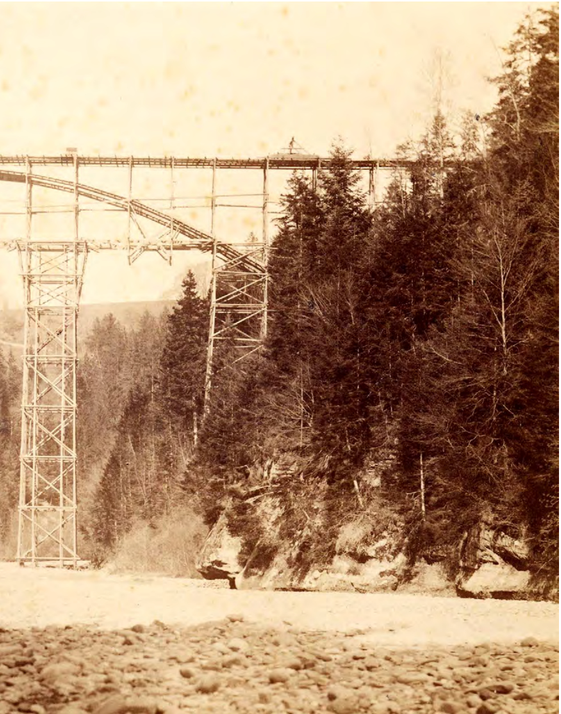
Figure 3.25 : Pont sur la Schwarzwasser en chantier en 1882. L'échafaudage est construit avec des troncs (Bürgerbibliothek Bern).
