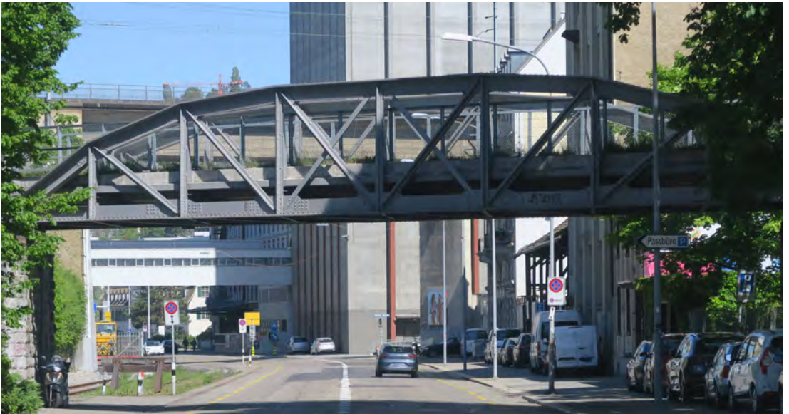
Figure 7.11 : Le pont de la ligne de Letten franchissant la route du Sihlquai à Zurich en 2021, affecté aux piétons et cyclistes. Les poutres sont de type Schwedler (1823-1894) : les diagonales du treillis sont en traction pour éviter les risques de flambage. Le projet du NOB est corrigé. Des croix de Saint-André sont ajoutées au milieu.
